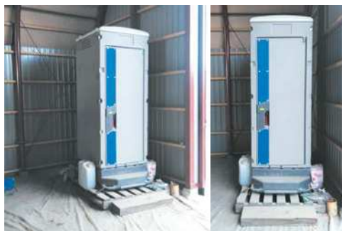
写真2.エコットトイレ 施設での設置例
