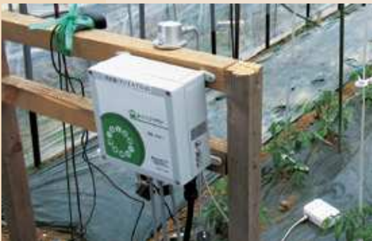
写真 2. モニタリングシステム設置状況 (株式会社セラク みどりボックス PRO)
